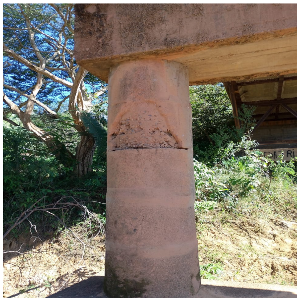
Foto 1º Pilar esquerdo da ponte na vicinal do limão.
